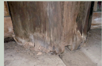
柱足元の腐朽の状況
